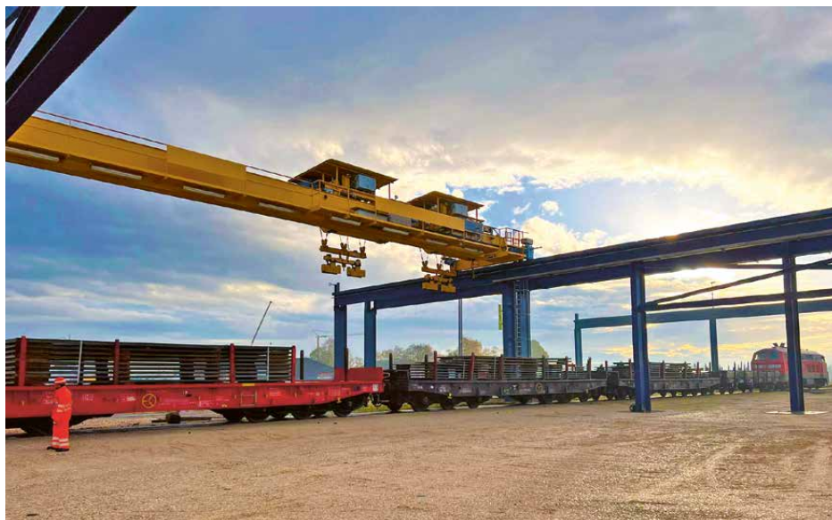
Die Entladung der Güterzüge findet nicht nur in der Halle, sondern alternativ auch auf der Freifläche unter leistungsfähigen Kranbahnen statt.
