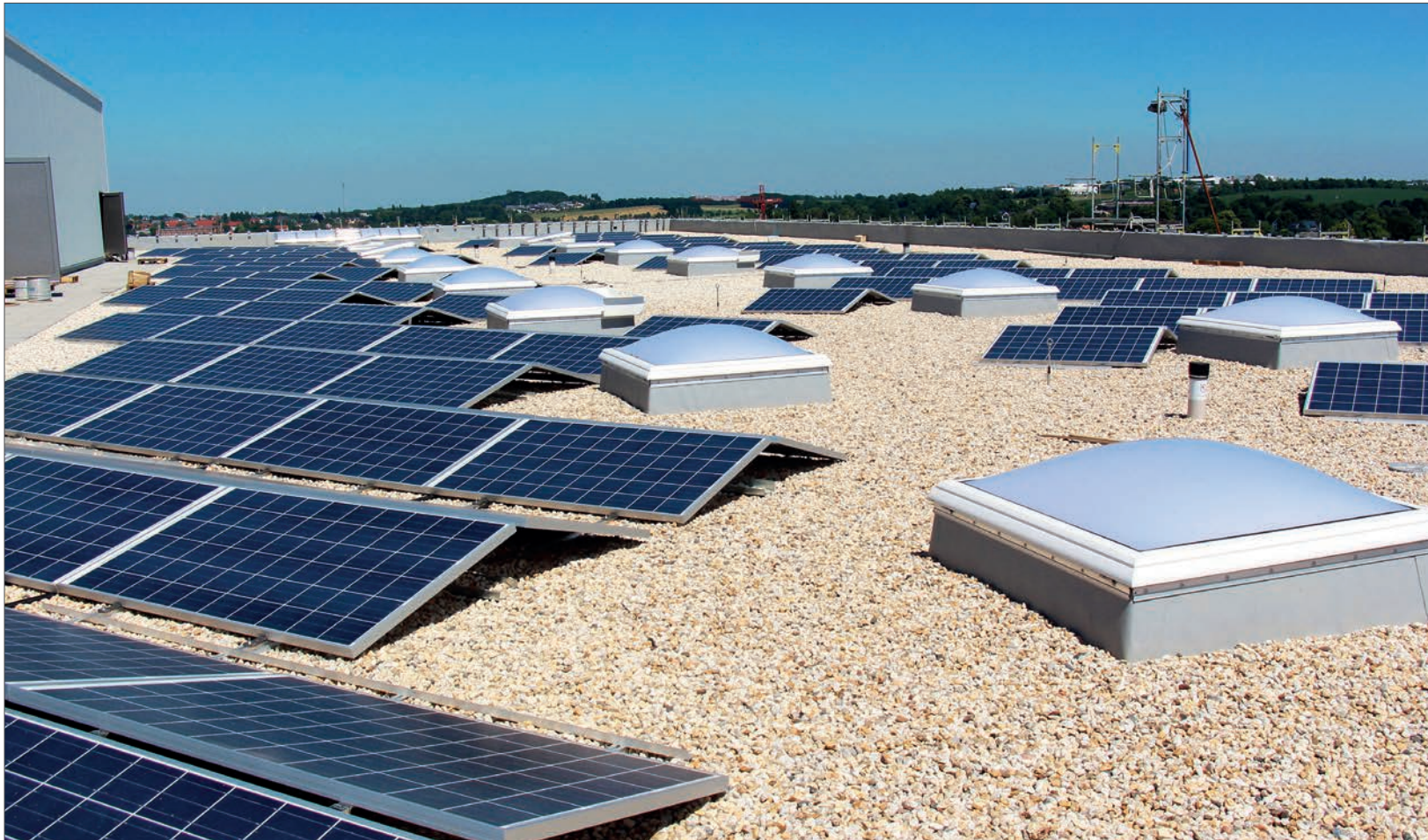
Photovoltaikanlage auf dem Dach des Hauses der Dienstleistungen.
